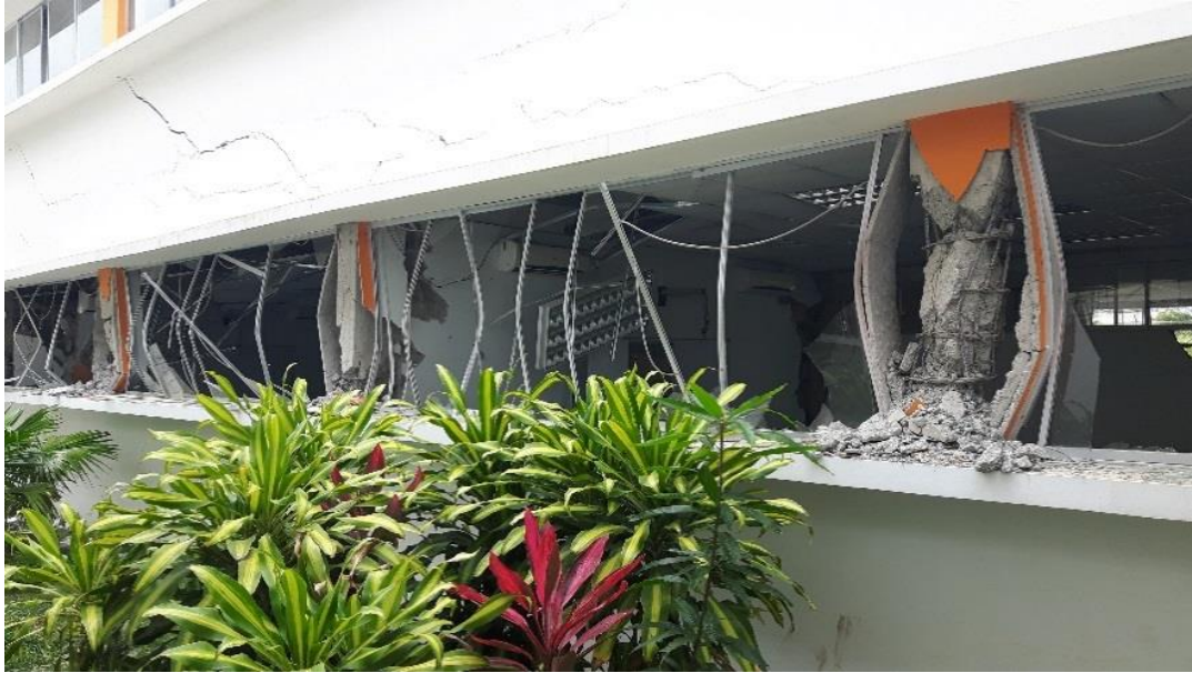
Foto 18. Ejemplo Internacional: Escuela del Milenio en Pedernales, Ecuador – Colapso por fenómeno de columna corta Fuente: DfID/Arup Respuesta al terremoto de Ecuador 2016
