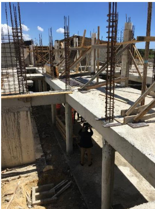
Foto 15. Escuela Juan Bosch 1 (en construcción) con posible irregularidad en planta
