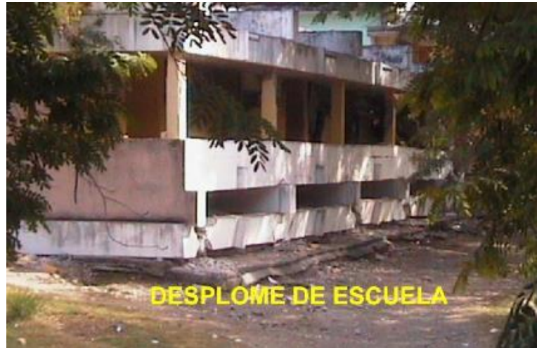
Foto 8. Escuela colapsada Puerto Plata (2003). Fuente: http://genao-alerta.blogspot.com/ mostrando el colapso total de la estructura de la primera planta
