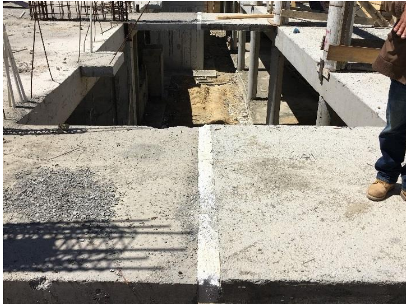
Foto 30. Juntas de expansión en accesos a las aulas (i.e., ruta de evacuación) Centro Educativo Juan Bosch
