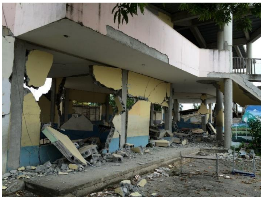
Foto 17. Ejemplo Internacional: Escuela en Pedernales, Ecuador - Colapso de muro en mampostería Fuente: DfID/Arup Respuesta al terremoto de Ecuador 2016
