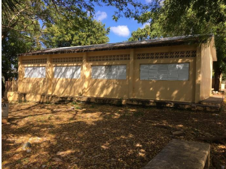
Foto 2. Escuela Básica Las Mercedes, fuera de servicio por agrietamientos, lo que enseña un estado que se quiere minimizar
